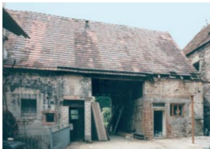
Hambar depozitare tutun înainte de reabilitare.
