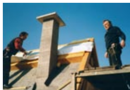
Pentru a atinge o valoare U \leq 0.10 \text{ W}/(\text{m}^2\text{K}) s-a folosit o izolație deasupra și între căpriori
